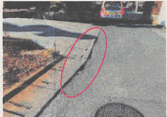
側溝脇の段差
